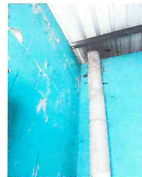
Foto 4: Chimenea de cocina no sirve.
