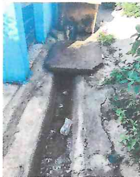
Foto 5: Drenaje en mal estado.
